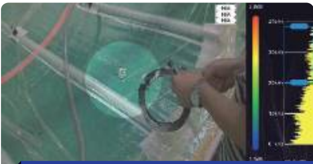
叶片主梁真空膜泄漏
