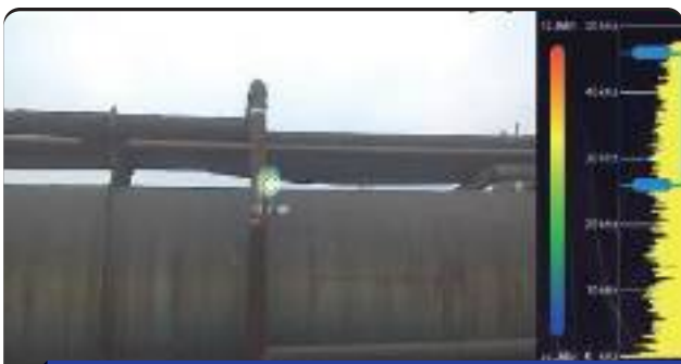
蒸汽管路泄漏
