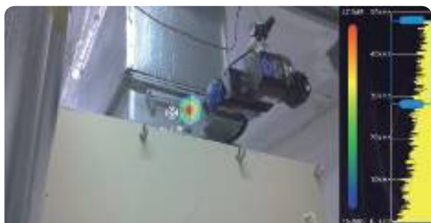
仪表气管接口泄漏
