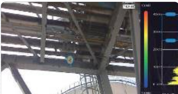
管廊管道焊缝泄漏
