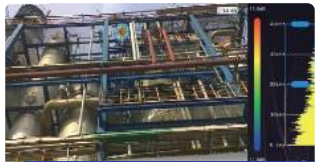
车间顶部管道接头泄漏
