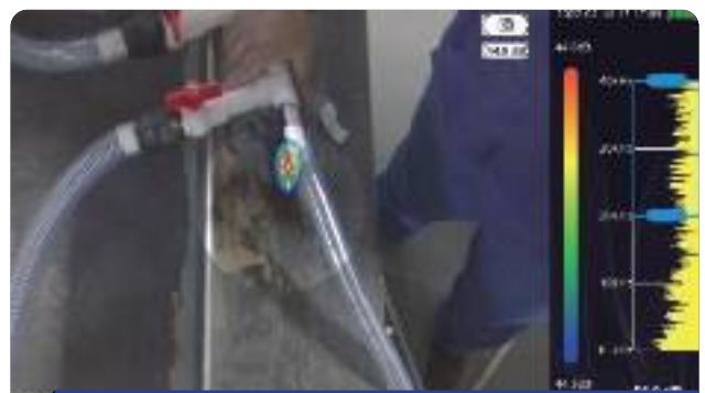
真空管接口泄漏
