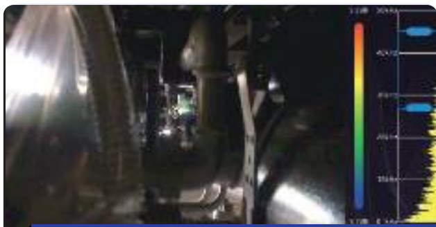
气管接头泄漏
