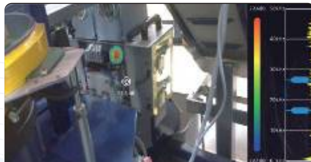
空气软管接口泄漏
