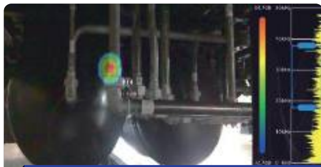
车厢底部接头泄漏
